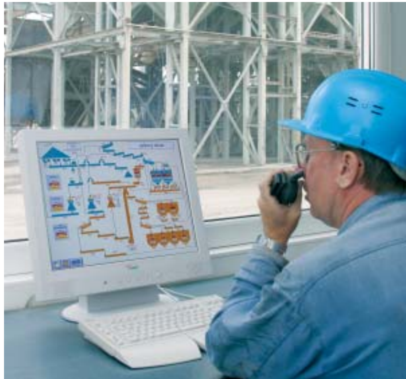
Prozessführung mit Prozessdatenerfassung einer Aufbereitungsanlage über einen Grafik-Flachbildschirm
