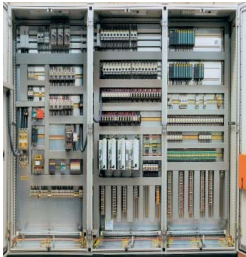
Schaltschrank mit Leistungs-, Steuerteil und Frequenzumrichter für Drehzahländerungen diverser Dosierbänder für eine Verladung
