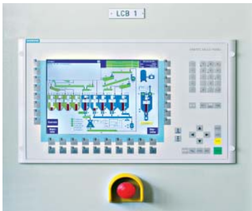
Visualisierung und Bedienung einer Rückbruchanlage über ein Operator-Panel
