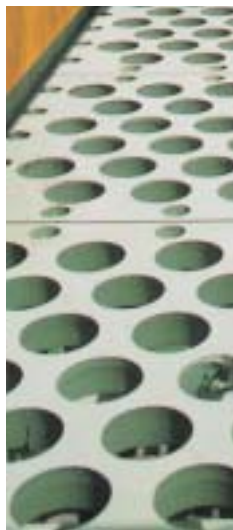
konisch gebrannte Lochbleche in einem schweren Vorabscheider
