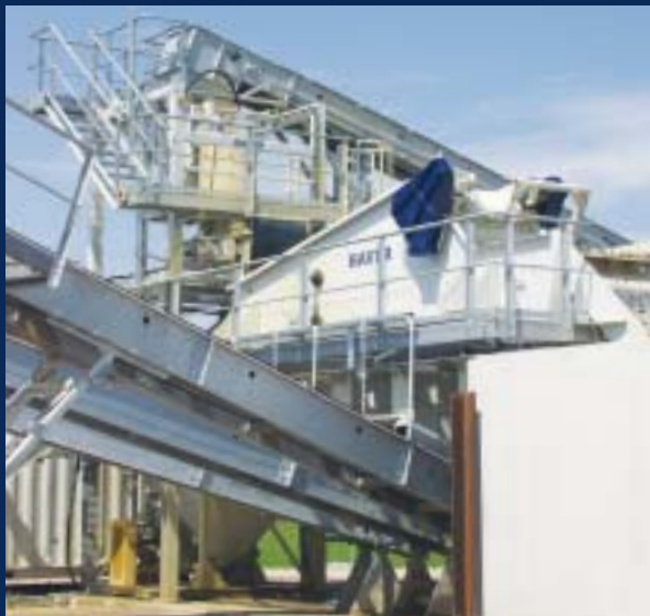
HAYER-Hochdruck-Wash- und Klassieranlage
